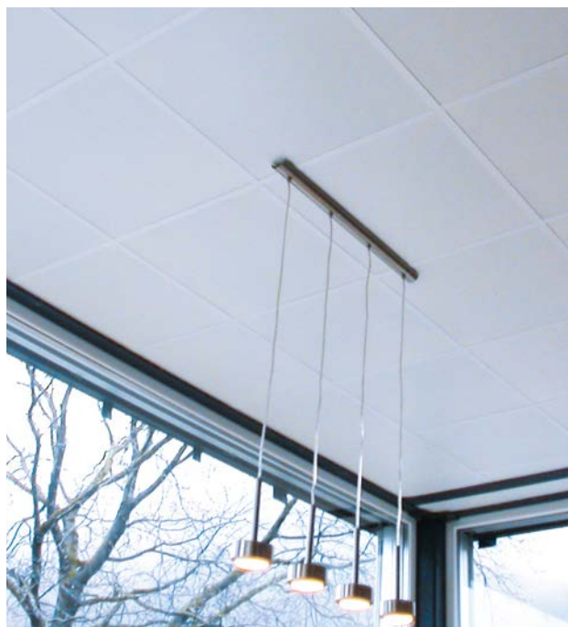
▲ Deckenabsorber aus SonoPerf, monochrom beschichtet
